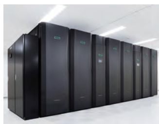
データ同化スーパーコンピュータシステム
